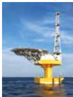
洋上変電所 「ふくしま絆」
